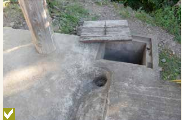
Trampa de sólidos de los sanitarios
